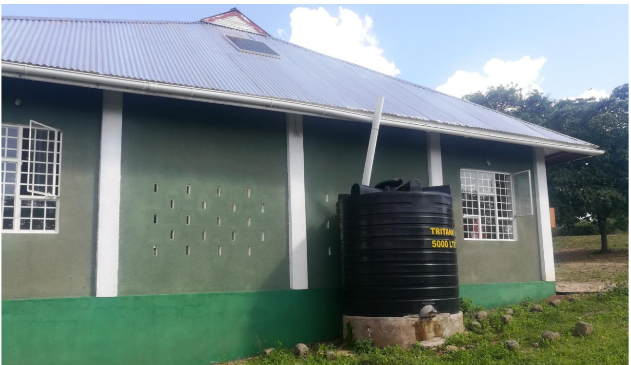
Abbildung 4: Wassertanks der Buschlinik müssen noch funktional angeschlossen werden
